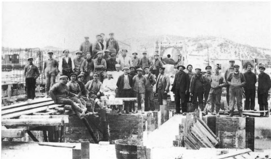
Arbejdsstyrken. Arbejdsmænd og murere. Slusens piller føres op som en skal af murværk, hvorefter kærnen fyldes med beton. I baggrunden anes Troldebjerg.
