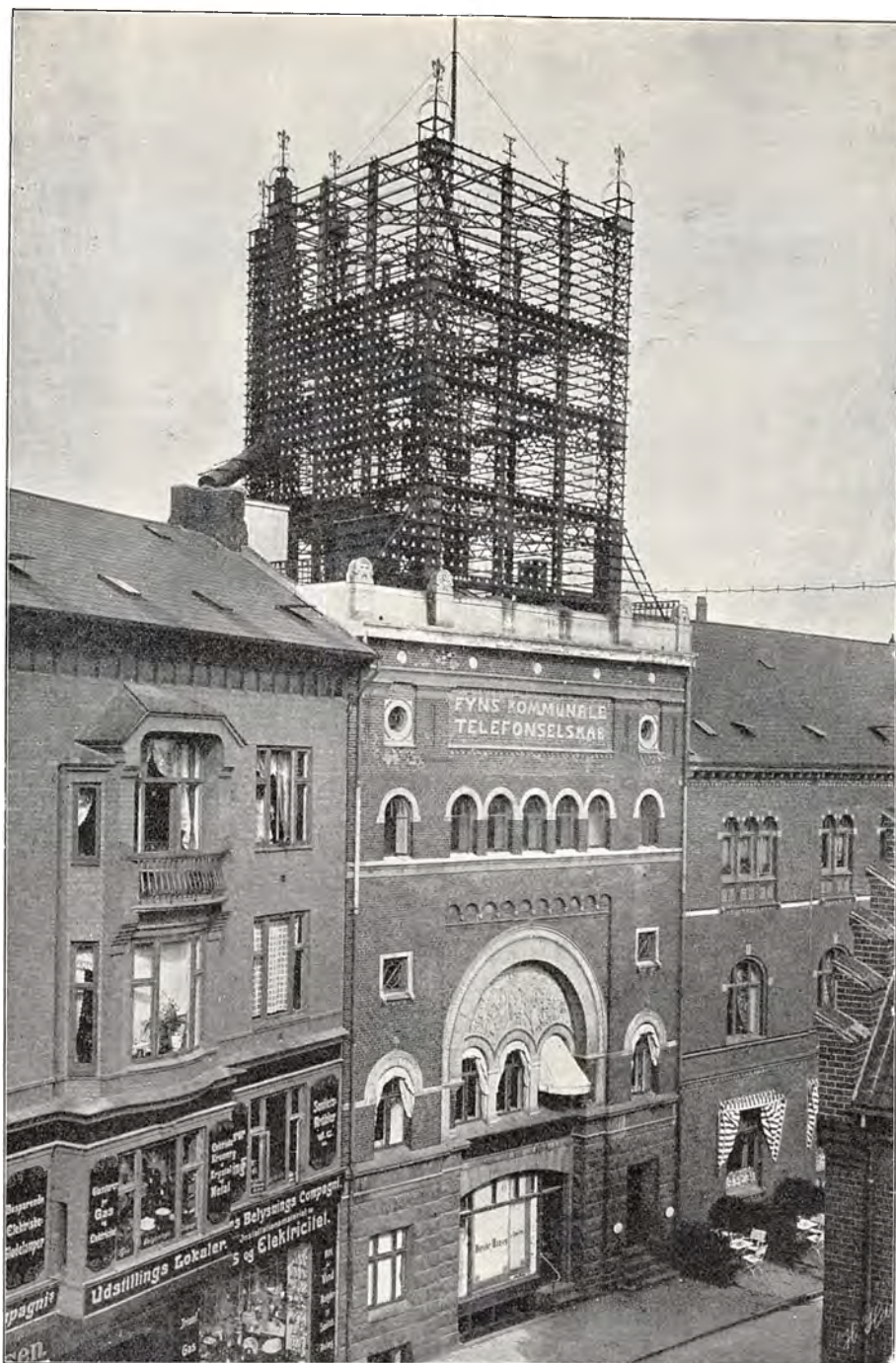
Telefoncentralen i Jernbanegade i Odense inden Overgang til Kabelanlæg. (Telefontårnet ses i fuld Højde).
