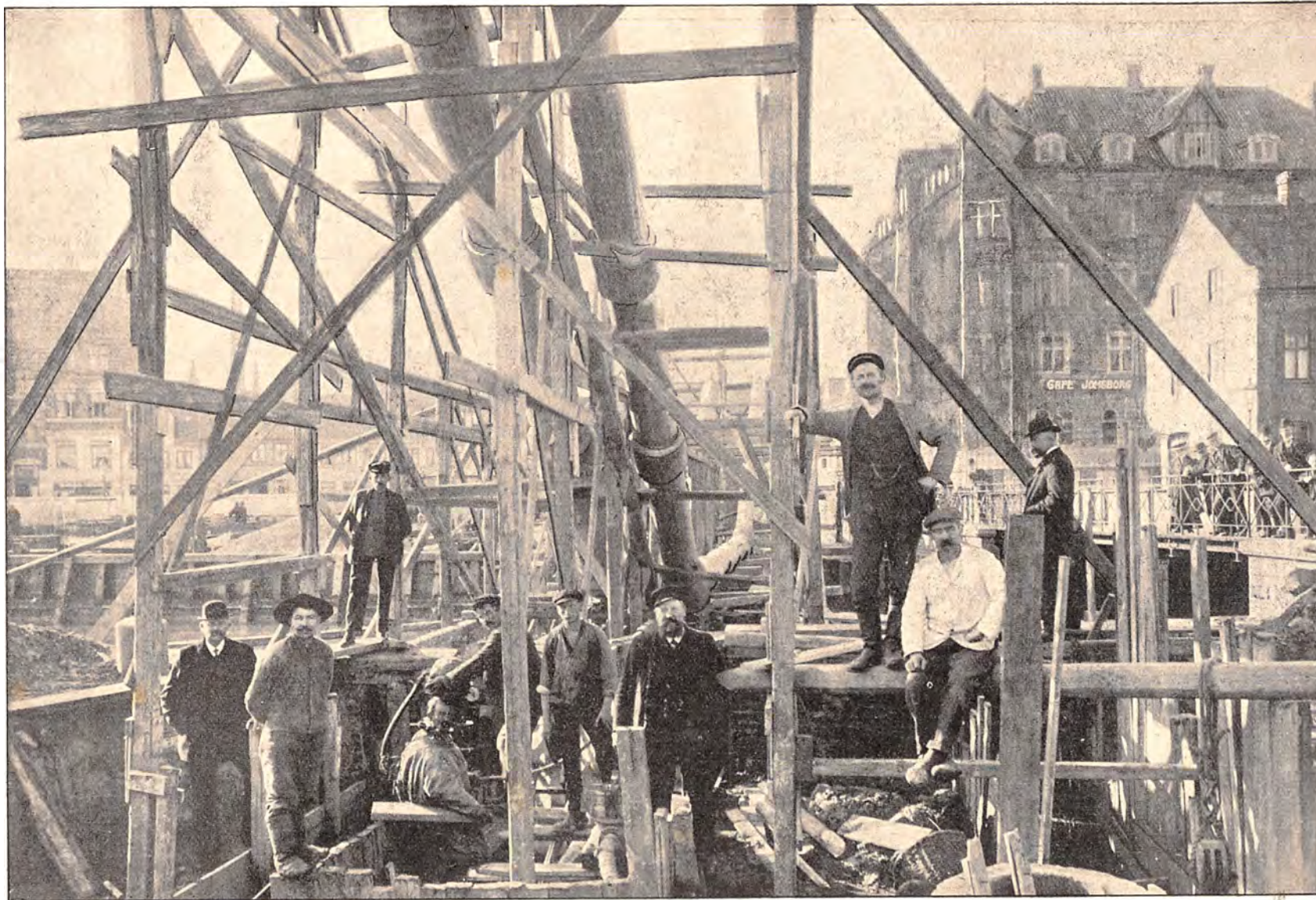
I Aarhus har man fornylig haft et meget vanskeligt Arbejde med to Ledninger, der skulde føres under Aarhus Aa. Ledningerne er udført af to svære Jernrør paa 105 Fods Længde, omstøbt med Jernbeton. Paa vort Billede ses de ophængt i et Stillads, færdige til Nedsænkning i en Dybde af 20 Fod under dagligt Vande. Saavidt vides, er saadan frithængende Cementstøbning enestaaende herhjemme.
