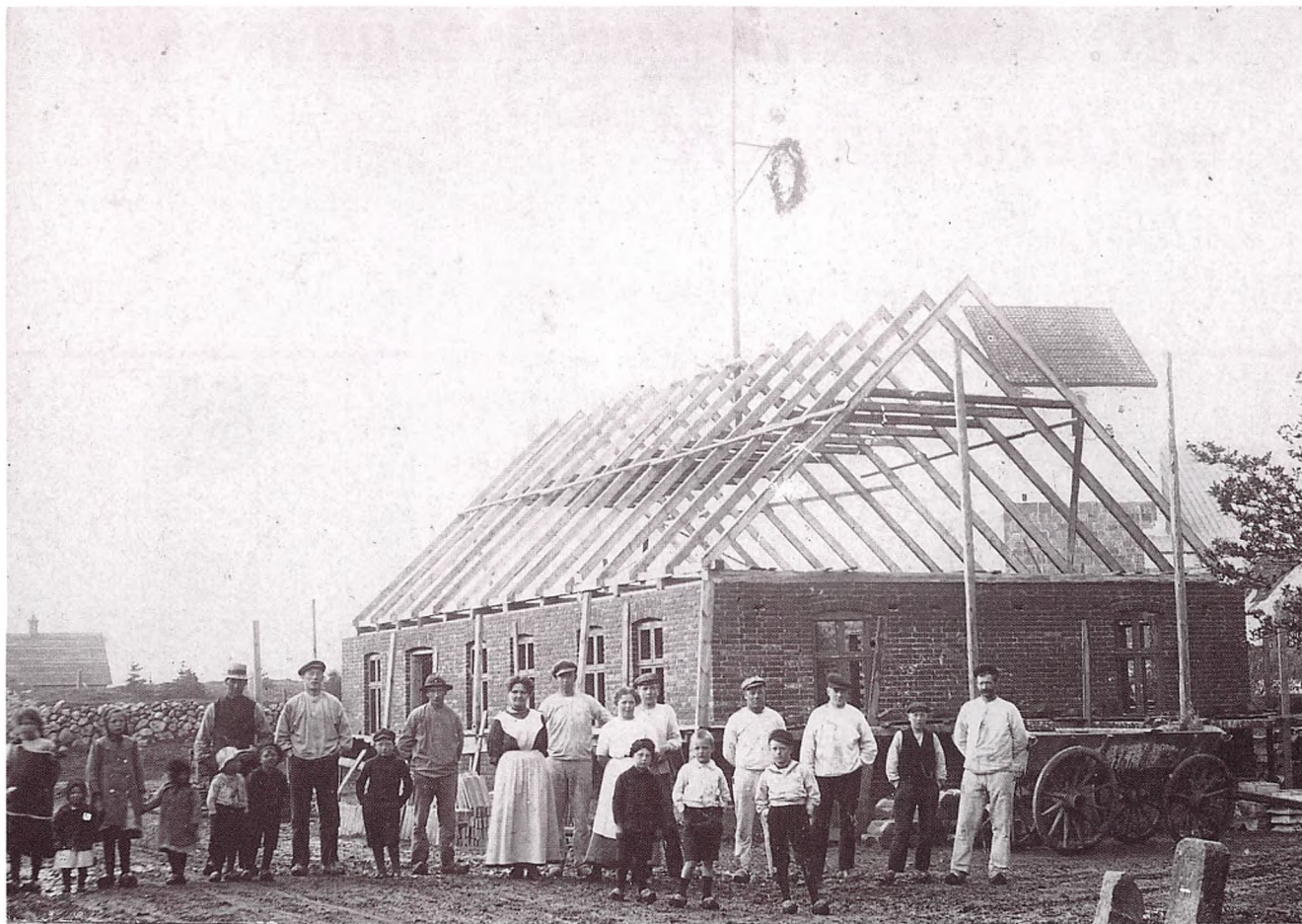
Rejsegilde under bygningen af forpagterbolig ved Sejerslev Kirke og præstegård. Bygningen er atter forsvundet. På stedet er der idag parkeringsplads.
