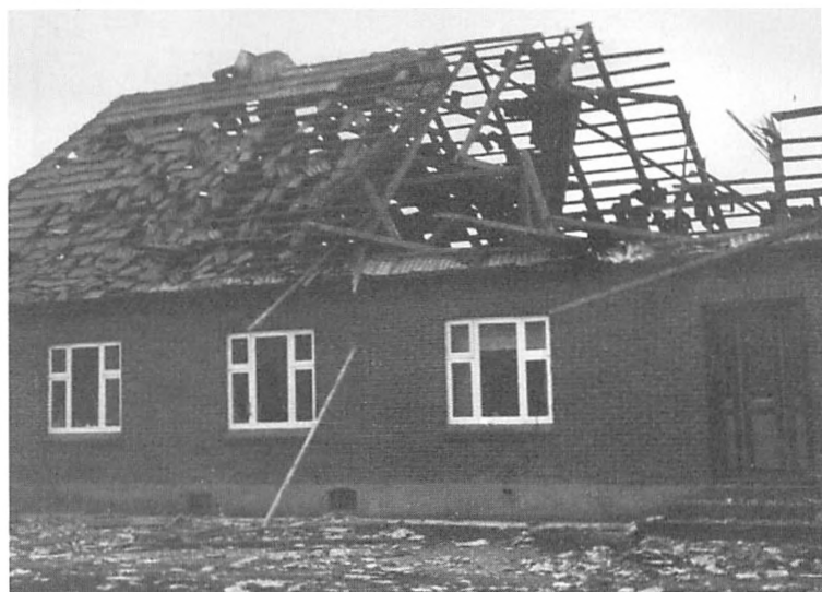
Kirkegaards stærkt beskadigede stuehus.
