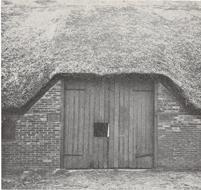
Fig. 10. Døre i den østlige Kørelo. De to rektangulære Vinduer lige under Murremmen er de oprindelige, Jernvinduet til Venstre er nyere
