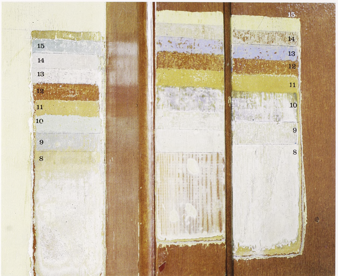
Fig. 3. Lagvis afsækning på vægplan og pille ved nuværende hovedtrappe fra 1913. Lag 8, som er påført i 1913, viser på pillen til højre en carraramarmorering og til venstre på vægplanet ses en okkerfarve. Denne farveholdning blev grundlaget for retableringen.
