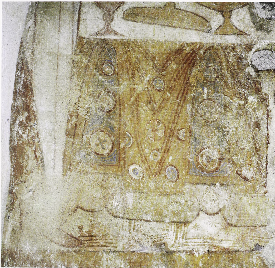
Fig. 22. Mårslet kirke, hovedfrisen, vestfaget. Partiet med saltskader efter fastlægning.
