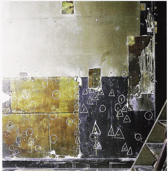
Fig. 5. Detalje af scenens bagvæg under arbejdet med stabiliseringen af det løstsiddende pudslag. Cirklerne (diameter 3-5 cm) angiver, hvor kasein-lim skal indføres, trekanterne, at det er sket.
