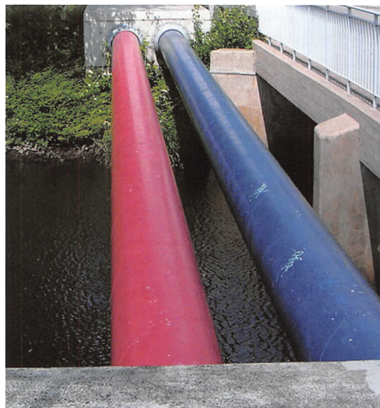
TVIS-rør fører vand ved 105° C til vekslerstationen.
