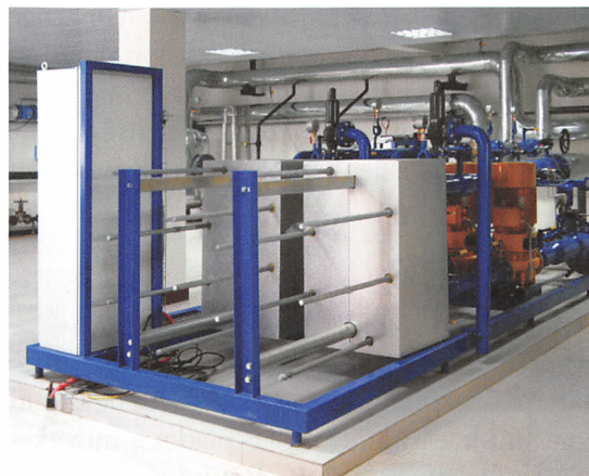
Fjernvarmeunit i boligblok i Habin i Kina.
