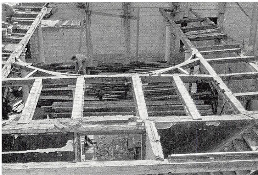
Fig. 12. Teatersalen under nedbrydning. Balkonens gulv og forskallingen nedenunder er fjernet. I forgrunden ses — mellem de to tværgaaende bjælker — det eneste bevarede gulvbrædt fra den oprindelige balkonfoyer. Paa brædet sidder endnu underkarmen til døren til loftstrappen. Forf. fot. 1957. — Jvf. fig. 11.
