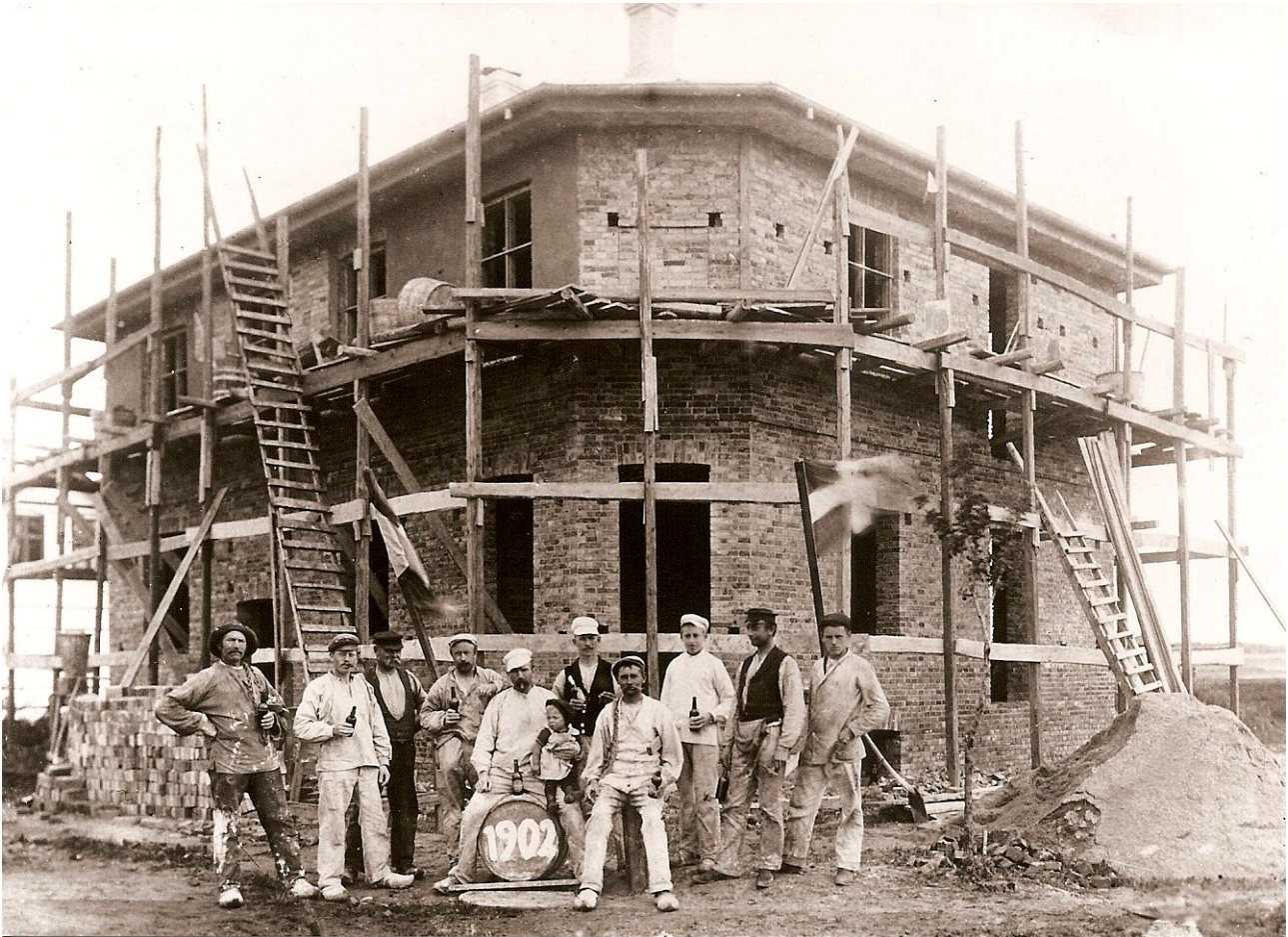
Forfatterens morfar som nr. 4 fra højre under opførelse i 1902 af en endnu eksisterende ejendom – oprindeligt som købmandsbutik – på hjørnet af gaderne Frem og Peter Rørdamsvej i Lyngby. Fra negativ i Lyngby-Tårnbæk kommunes byhistoriske samling.
