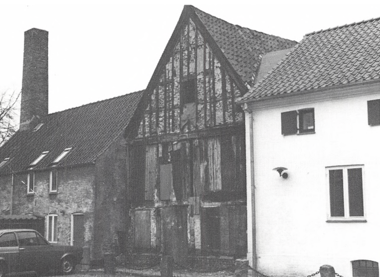
Sidehusets sydgavl. Det fremgår tydeligt, at tavlenes udmuring yderst har haft en lerklining, som nu delvis er faldet af. (Foto i privateje).
