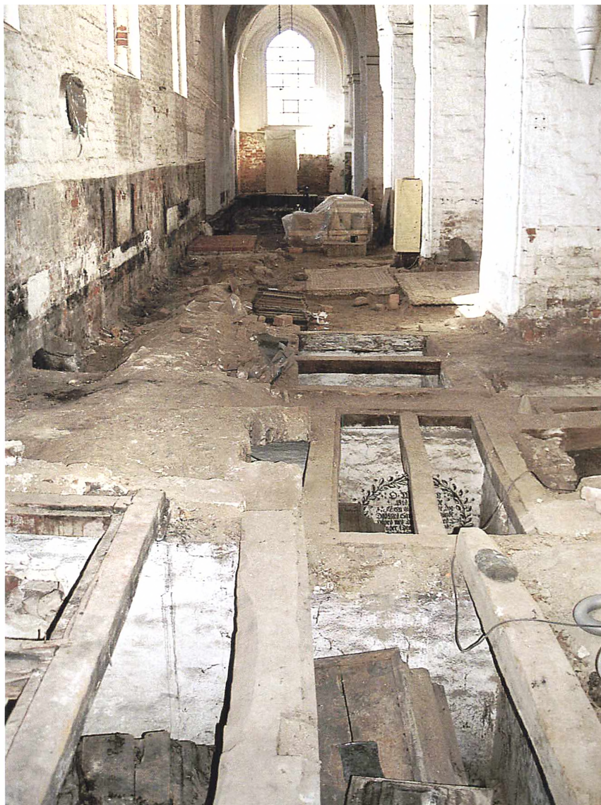
I Skt. Olai Kirke i Helsingør stod kisterne stadig i stabler, da krypterne blev undersøgt i 2000. Sådan må der have set ud i Trinitatis Kirke, før Nationalmuseet »ryddede op« i 1920'erne. Der er tilgængelige krypter i fx Skt. Petri Kirke på Nørregade i København og i Christianskirken på Christianshavn. Foto: Helsingør Bymuseum, Torben Bill-Jessen.
