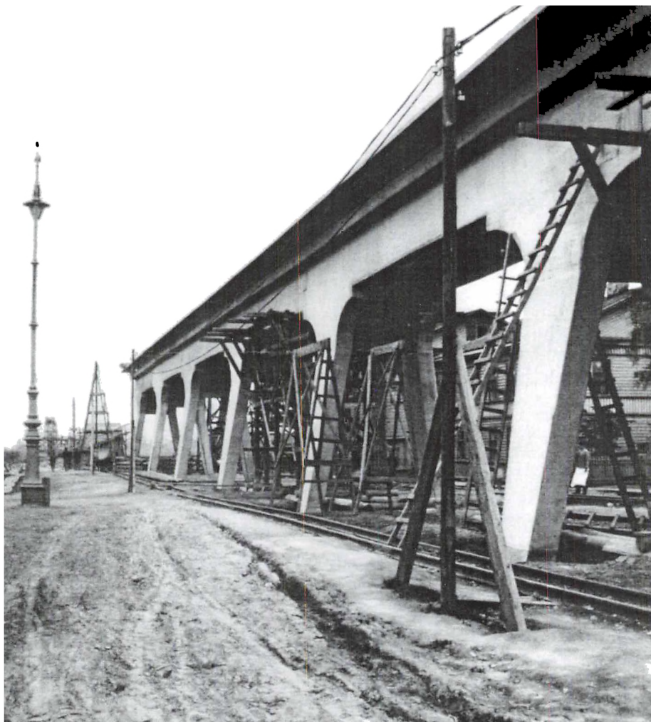
Den 610 meter lange rampe til Finlandsbroen i Skt. Petersborg, bygget af Christiani & Nielsen 1910-13, et af de største arbejder i jernbeton i Rusland i begyndelsen af 1900-tallet. Erhvervsarkivet.
