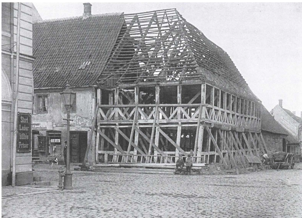
I forbindelse med Det skæve hjørnes opretning blev alle tavler fjernet, så tømmer skeletet kunne skrues op mod den nye bagmur til gården og mod Kragssnapps Hus. Fotografiet afslører den brede revne, der var kommet mellem bygningerne, og som muligvis skyldes en dårlig tilpasning fra starten. Men grunden var antagelig også sunket. Foto Nationalmuseets 2. afdeling, 1898.
