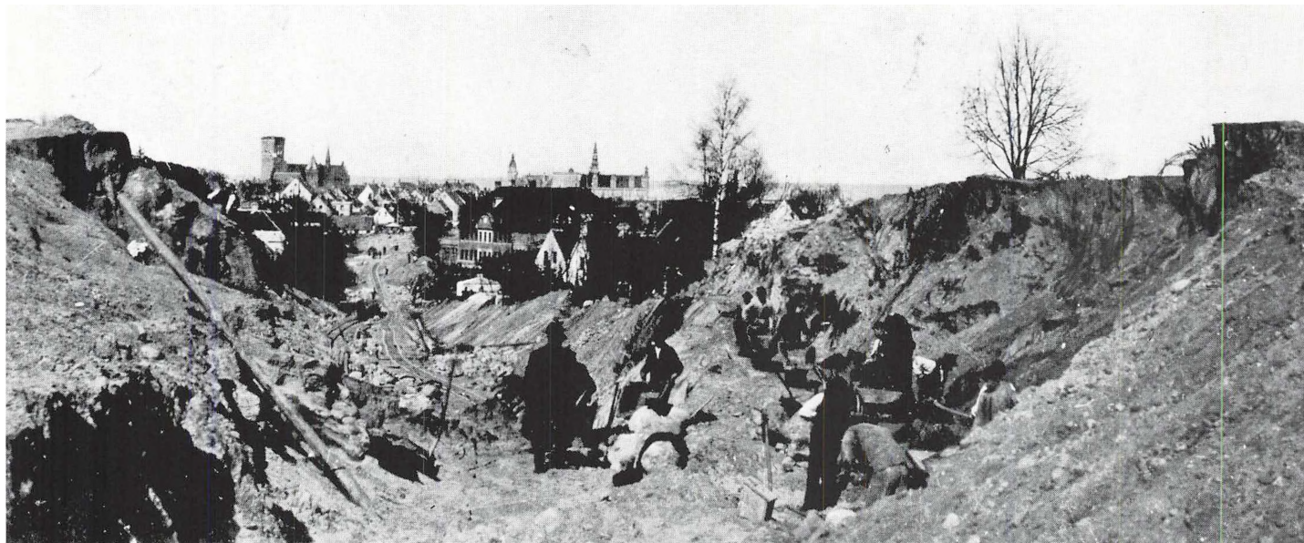
Omlægningen af Nordbanen mellem Snekkersten og Helsingør Havn krævede betydelige jordarbejder. Her er man nået til de store bakker umiddelbart sydvest for byen. Det var et hårdt og slidsomt arbejde. Ofte var det udefra kommende arbejdssjak, der udførte den slags arbejde. »Jernbanebørster« blev de kaldt.
