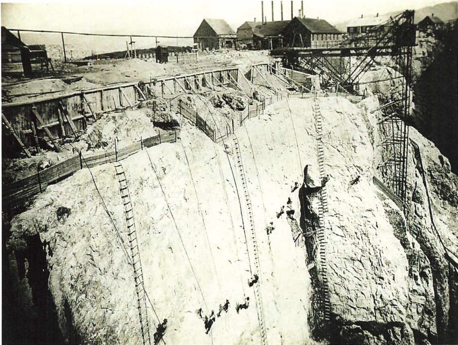
Dynamitten skal placeres, så der kan gøres klar til efterfølgende sprængning i bruddet. Foto: Kryolitselskabet Øresund A/S' arkiv, Erhvervsarkivet.
