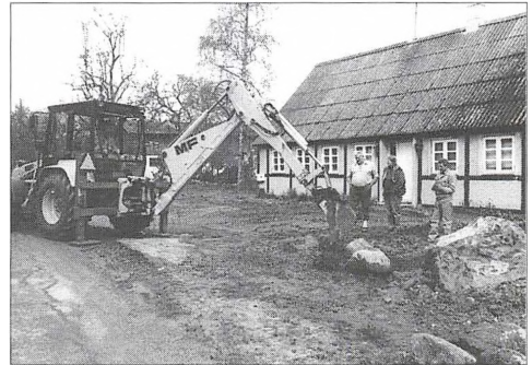
Dækslet over den gamle fællesbrønd ved gadekæret i Stouby var skredet sammen. Falsters Minder var til stede da Sydfalster Kommune afdækkede den stensatte brønd.
