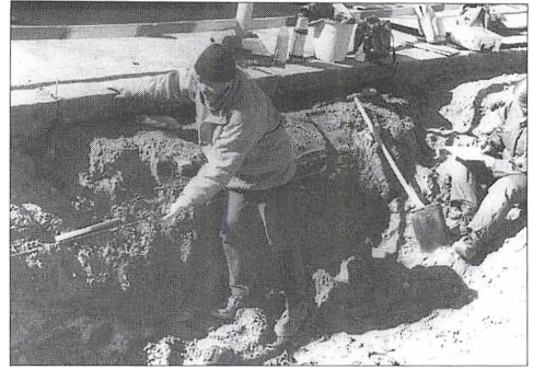
I disse år etableres og udskiftes fjernvarmerør over store dele af Nykøbing F. Når entreprenøren for eksempel, som her på Finlandsvej, støder på knogler, rykker museet ud for at undersøge fundet og eventuelt foretage opmåling og udgravning. Denne gang var der dog blot tale om en nedgravet hest fra en gård, der har ligget i området før det blev bebygget med parcelhuse.
