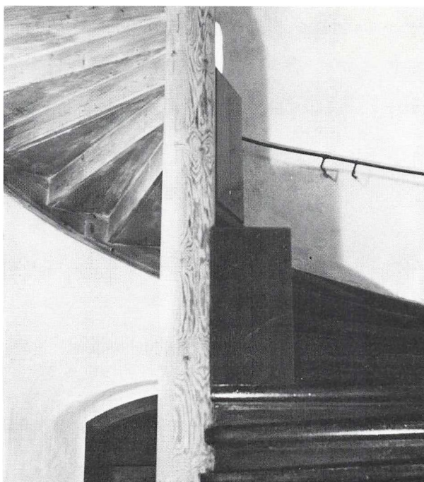
Trappen på Rudbjerggaard. Denne trappe er først opstillet i 1870'erne, men i et ældre trapperum, derfor er trinnene ikke muret ind i væggen, men fastgjort til en bagvange. Fot. 1978.
