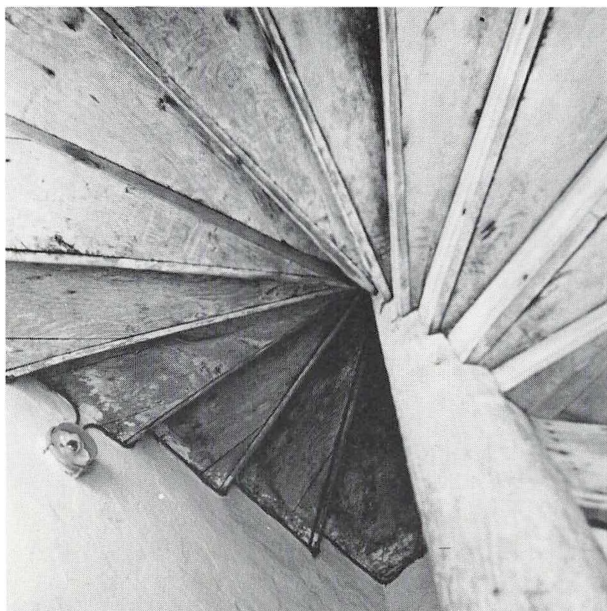
Trappen på Esrum Kloster. Trappens underside set op langs spindelen. De nyere stødtrin er sømmet på de underliggende trinbagkanter. På trinfladernes underside ses mærkning med romertal. I spindelen ses, bag stødtrinnene, en række dyvler, der har holdt de oprindelige stødtrin på plads. Fot. 1978.
