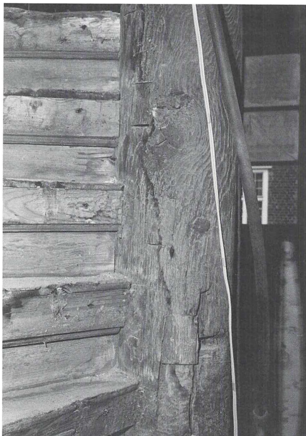
Sønderborg Slot. Detalje af trappen i tårnet ved sydfløjen. I den originale spindel ses tydeligt taphullerne efter de oprindelige trinender og foran disse dyvlerne, der har holdt trappen sammen. Fot. Nationalmuseet 1970.
