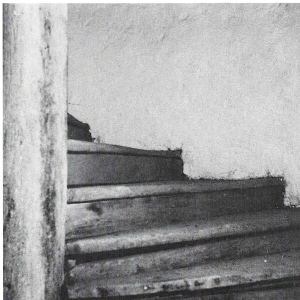
Tårntrappen på Lerkenfeldt. Det ses tydeligt, hvorledes trinfremspringet aftager ud mod tårnmuren. Fot. 1978.
