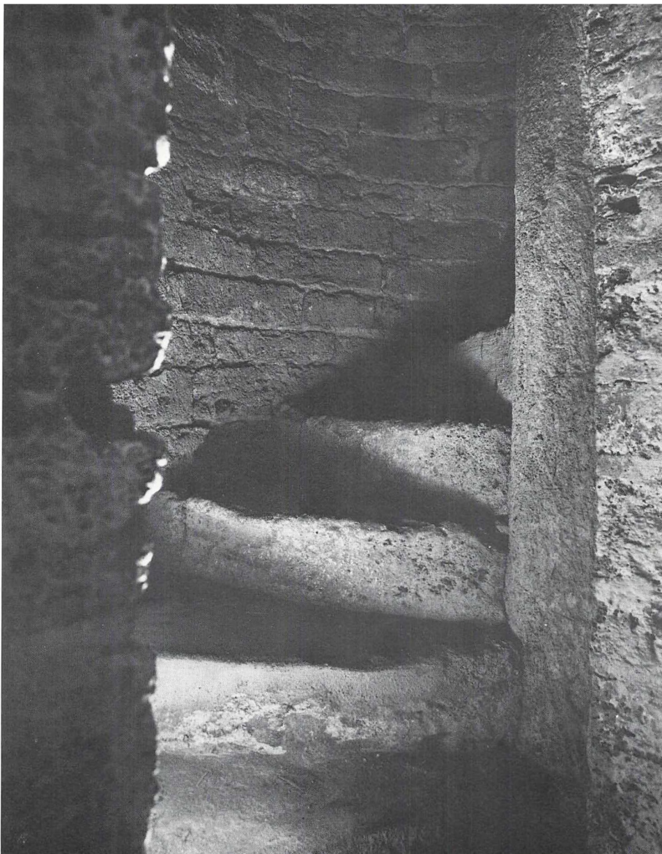
Vindeltrappe i frådsten i Venge klosterkirkes vesttårn. Hvert trin er hugget i én stor blok, der er muret ind i tårnvæggen og tildannet rundt om trappens lodrette midterakse – den runde spindel, der ligeledes er hugget i frådsten. Her ses begyndelsen af spindeltrappens løb, der fører fra anden etage og videre op i tårnet. Fot. Poul Pedersen, 1982.
