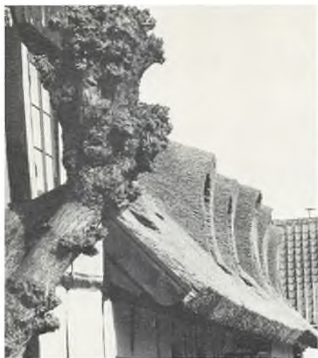
Stråtagkviste i søndre tagflade på Jens Eyberts Plads 6 og der bag Skipperstræde 3, efter branden. (NM 1978).
