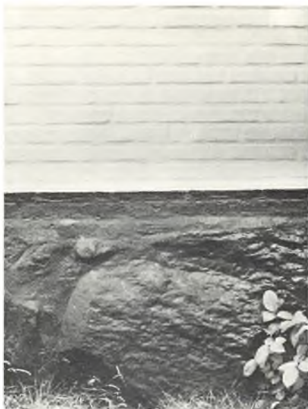
Murværk med brændte fuger og tjæret sokkel, Jens Eyberts Plads 1. (Fot. Sv. Jans, DL).
