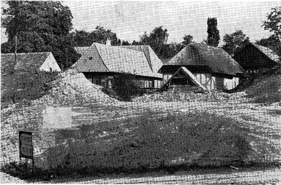
Museumsudvidelsen, der påbegyndtes i efteråret 1978. På dette sted skal Brøchners pakhús placeres. Foto: P. A. Honoré.
