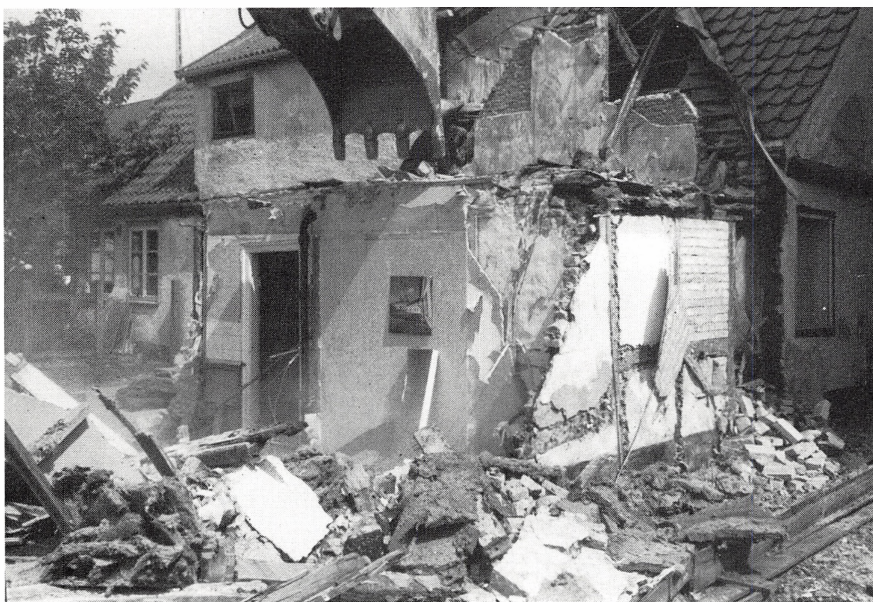
Der gøres plads til det nye torv. Baghuset til Bagges Minde rives ned juni 1993
