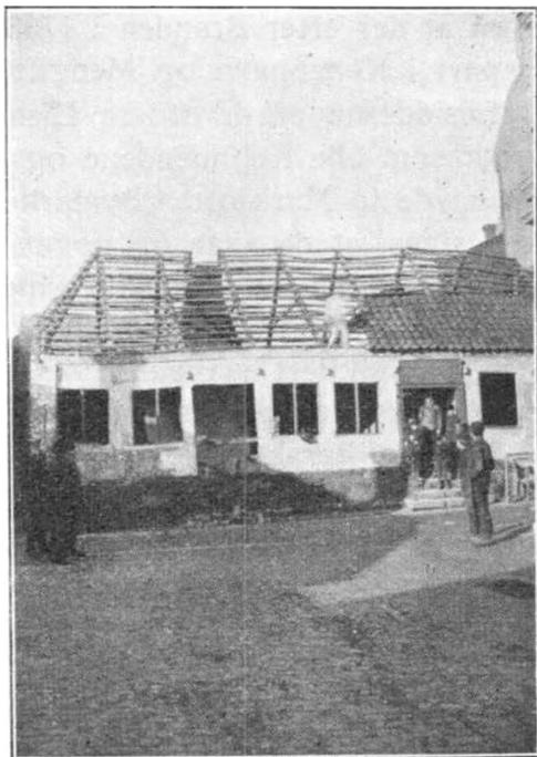
Læderhandler Helms Ejendom, Nørregade, opført efter Branden 1734 af Byfoged FASTERLING til Kontor og Bolig, med svære Egetræsbjælker og tykmavet Skorsten. Nedrevet 1890.
