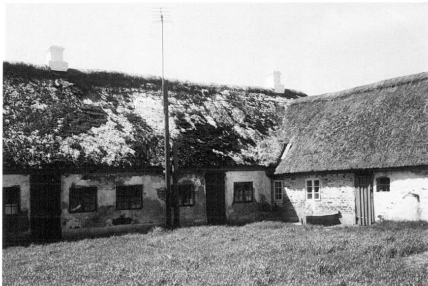
Gårdspladsens hjørne mellem stuehuset til venstre og stalden til højre, 1970. Den smukke pikstens-brolægning er skjult under græsset. Stuehusets mur er opført i ubrændte klegsten.
