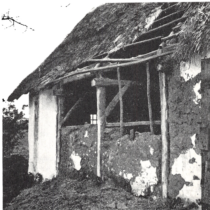
Fig. 4. Bindingsværk fra Odsberred. Lervæggene er delvis faldet ned, så man kan se vægkonstruktionen. – Gård i Sonnerup, Højby sogn.
