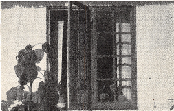
Et af de gamle Vinduer i Langesø Skole. Bemærk den ejendommelige Maade, hvorpaa de lukker.
