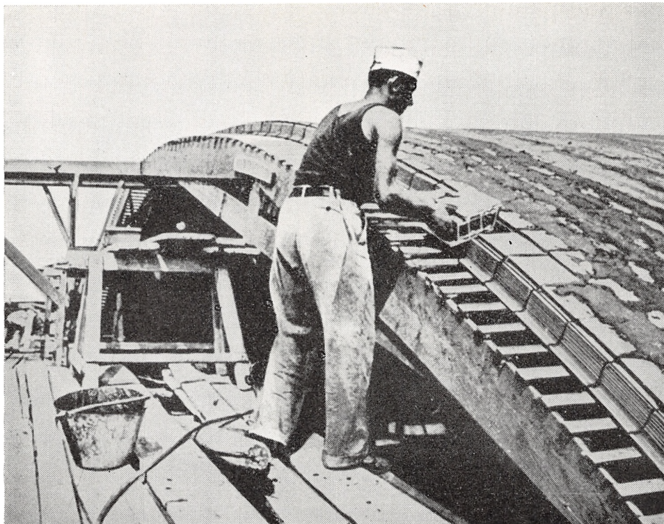
Fig. 3. Muring af tøndehvælvning med den på fig. 2 viste specialsten; henmuringen foregår på en smal, flytbar form.
