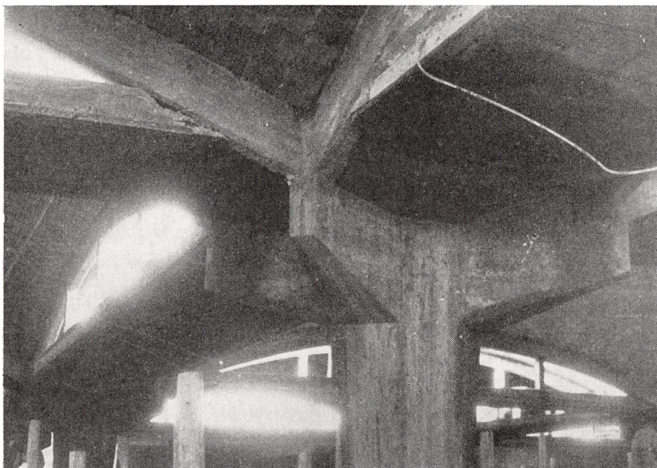
Fig. 6. Søjle og jernbetonbuer under et af krydsningspunkterne for de på fig. 5 viste kupler.
