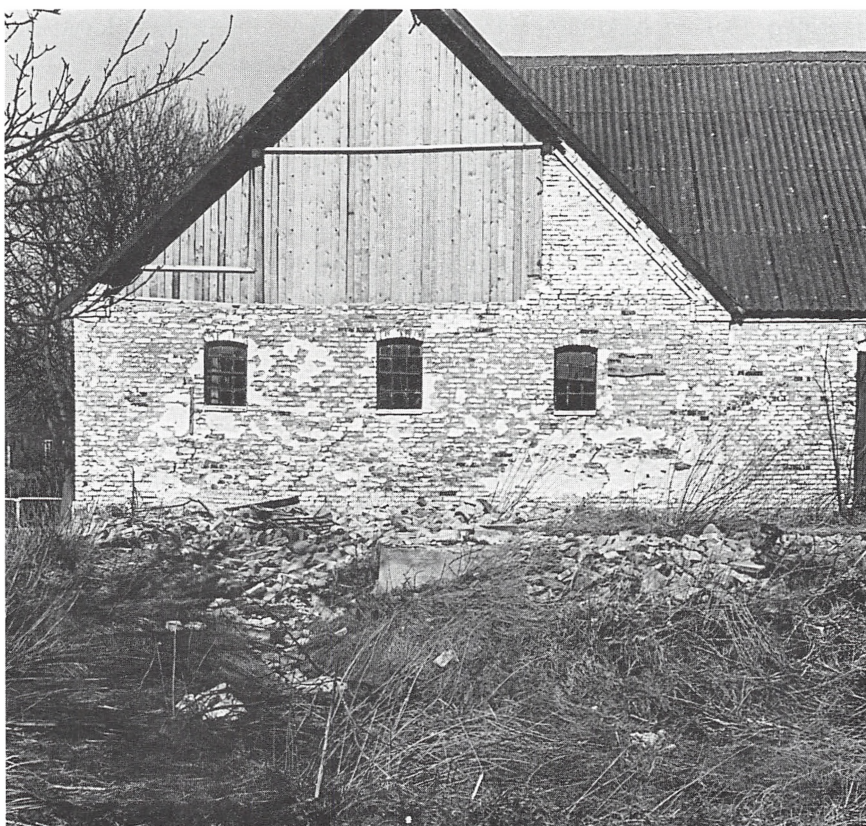
Fig. 19. Under en orkan i oktober 1967 blæste en gavl ud på Vigholmgård, men heldigvis kom ingen personer til skade, og de opmagasinerede genstande blev heller ikke ødelagt. Det opståede hul blev nødtørftigt lukket med en bræddewæg.
