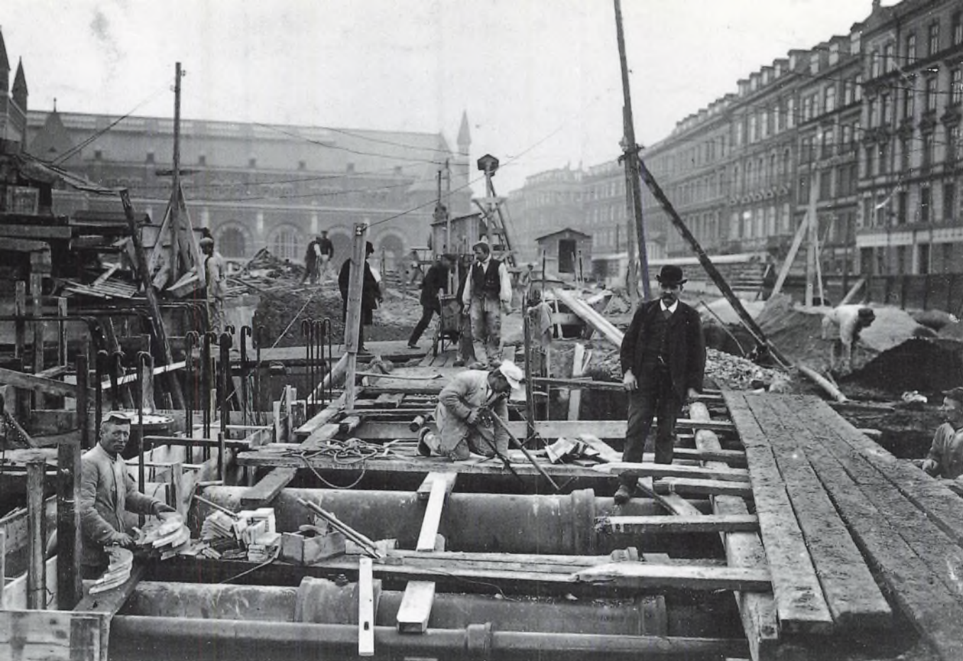
Byens gas-, vand- og kloakforhold var en bombe under den voldsomt ekspanderende hovedstad. En samlet løsning på problemet trængte sig på allerede før 1850; men politikerne tøvede med at træffe den udgiftstunge beslutning. Her arbejdes med anlæg af gas- og kloakledninger foran Hovedbanegården. 1911. (Det Kongelige Biblioteks Billedsamling)
