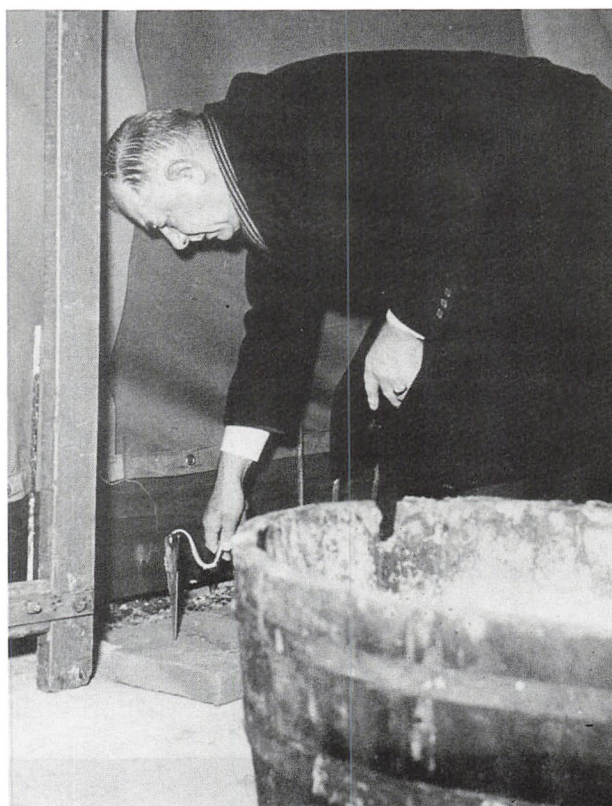
Grundstensnedlæggelsen til amtssygehuset fandt sted den 17. november 1953. De første to sten blev indmuret af stiftamtmand Ove Larsen og sygehusudvalgets formand, administrationschef Poul Stockholm.
